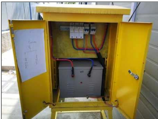
生活区低压用电设施实例图
