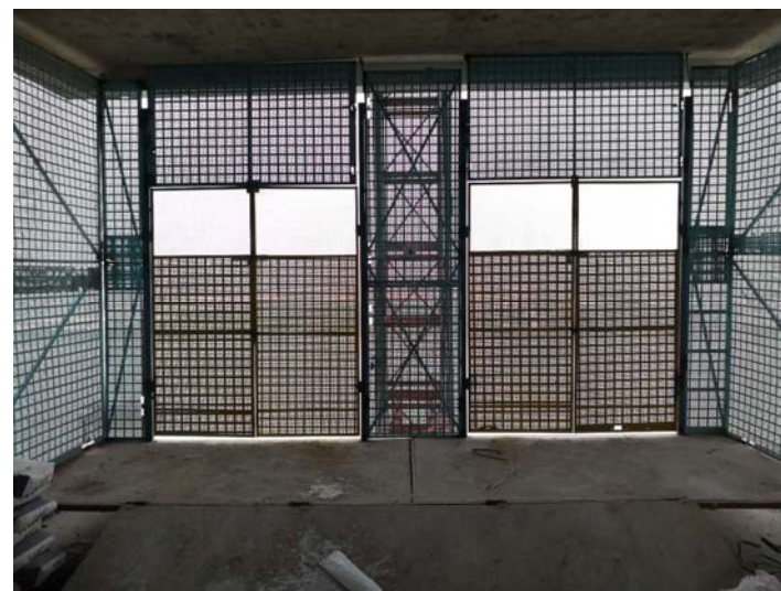
停层平台两侧设置防护栏杆、挡脚板
