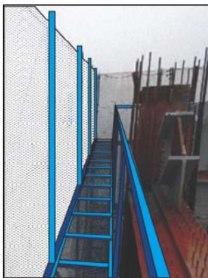
临边防护栏杆
